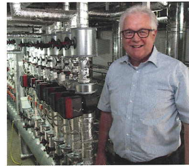
Peter Leuker stellt das Blockheizkraftwerk vor: Die neue, gasbetriebene Heizanlage produziert Wärme und Strom und ist deutlich wirtschaftlicher und umweltfreundlicher als die alten ölbefeuerten Heizkessel.
