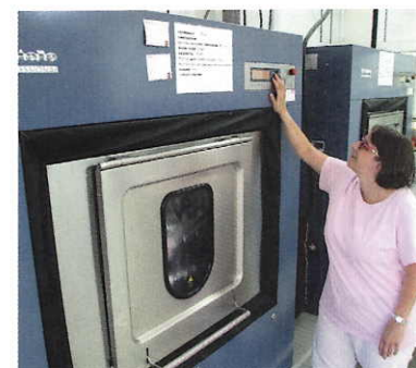
Die neue Wäscherei: Moderne Maschinen und eine neue Raumaufteilung schaffen optimierte Voraussetzungen für die Aufbereitung der Bewohnerwäsche, Dienstkleidung und Reinigungstextilien.
